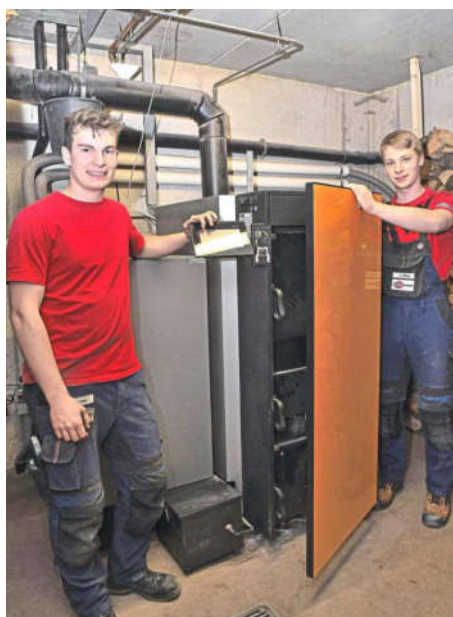
Von Heizungsanlagen verstehen auch schon die beiden Auszubildenden Jonas Fischer und Aaron Bühler etwas.
